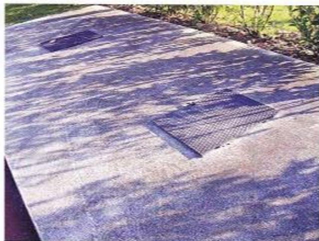
Ossarium do składania szczątków i prochów z likwidowanych grobów. Wygląda jak studnia kanalizacyjna i nie służy najlepiej kultywowaniu pamięci zmarłych
